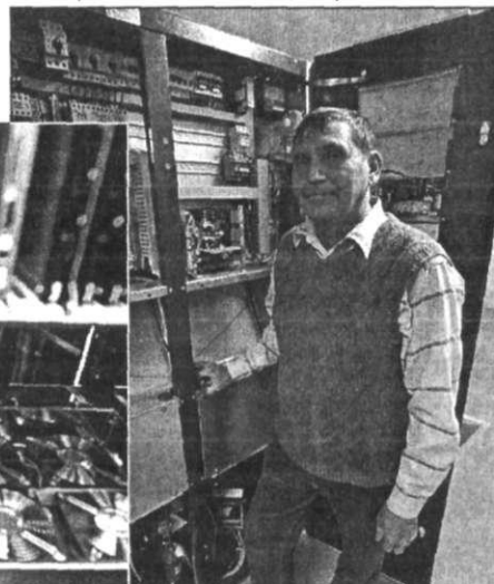
Александр Заляшин , начальник сервисного центра фирмы «КОНДИ» рядом с кондиционером, смонтированный им самим. Именно так, как шкаф, выглядит прецизионный кондиционер.
